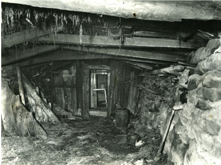
Intérieur de l'étable du n° 42 au moment où elle a été prise en charge, illustrant l'affaissement des fermes
