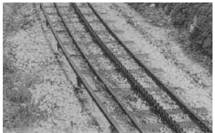
Fig. 10 - Détail de la voie en amont du tunnel ; à gauche le troisième rail alimenté en 600 volts et au centre la double crémaillère Abt entre les rails de roulement espacés d'un mètre (1914)
